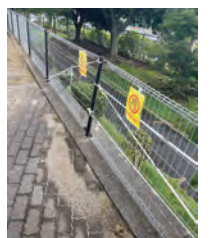
倒れかかった フェンス
