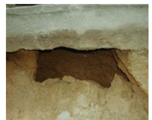
石垣の巨大な隙間＝馬木地域の住宅
