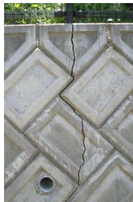
(写真) 福木トンネルの工事で地盤沈下して亀裂が入った石垣
