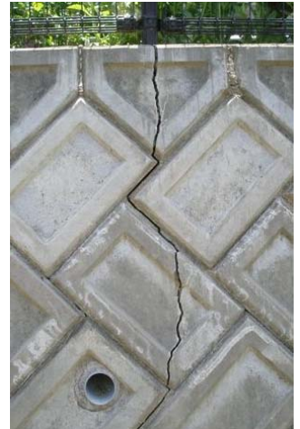
地盤沈下で亀裂が入った石垣=5月13日撮影
