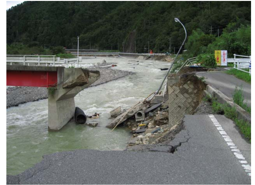
(写真2) 崩落した農村環境改善センター前の橋。昨年の台風災害の復旧工事の遅れが誘因。
