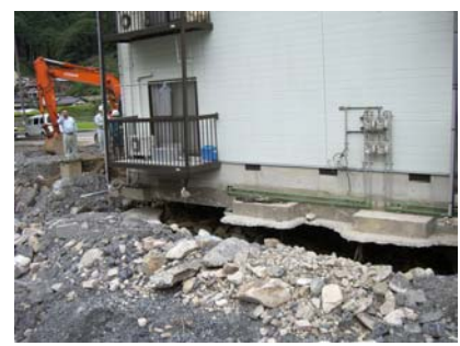
(写真2) 建物の底がえぐられて倒壊のおそれがある共同住宅
