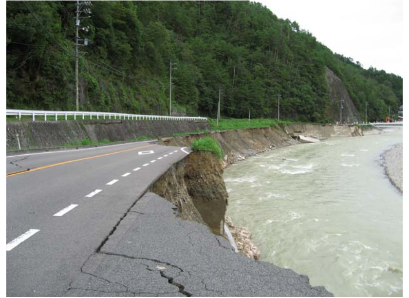
(写真1) 決壊した国道433号線。生活道路が通行止めになり、通勤、通院、通学、保育園の送迎など生活に大きな影響を与えています。
