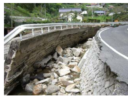
(写真4) 車線の片側が崩落した小河内の道路
