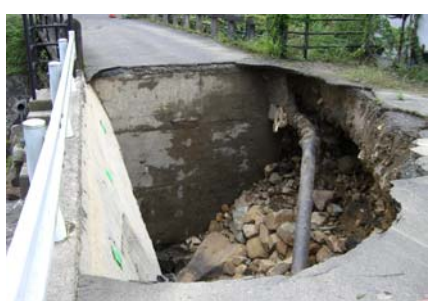
(写真3) 道路が大きく崩落し通行できない小河内小学校の通学路
