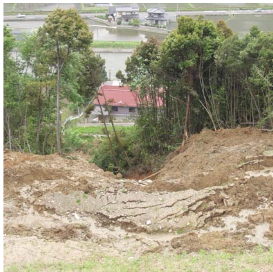
【17日発生直後・現場上から】 土砂が吸い込まれるように崩れていった様子がわかる
