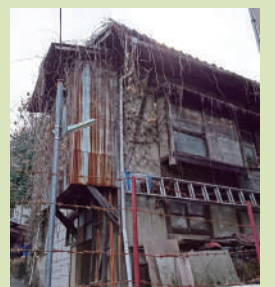
危険な老朽空き家
