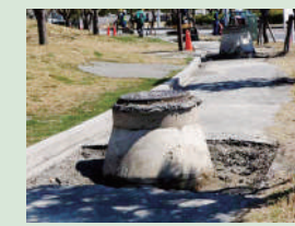
液状化で浮き上がったマンホール
