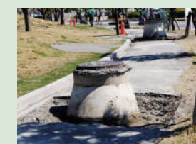
液状化で浮き上がったマンホール
