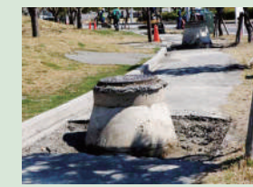
液状化で浮き上がったマンホール
