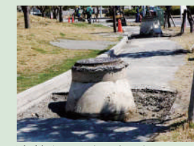
液状化で浮き上がったマンホール
