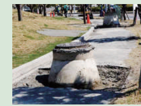
液状化で浮き上がったマンホール
