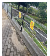
倒れかかった フェンス
